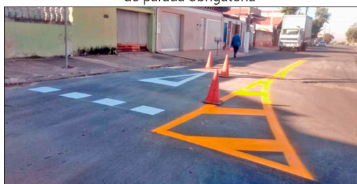
Sinalização horizontal de Dê a preferência
