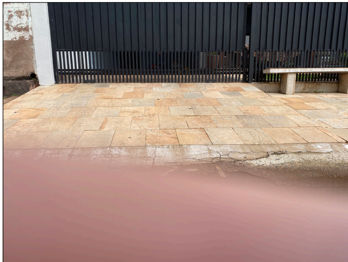
Figura 8.33 Calçada com inclinação transversal excessiva. Fonte: Foto dos autores.
