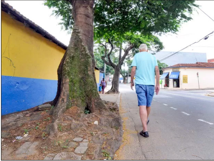
Figura 8.20 Calçada destruída levantada por árvore obstruindo a calçada. Fonte: Internet.
