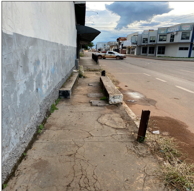
Figura 8.13 Calçada obstruída por peça de concreto. Fonte: Foto dos autores.
