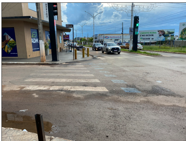
Figura 8.19 Ausência de guia rebaixada e obstrução na faixa de pedestres por postes em esquina semaforizada. Fonte: Internet.
