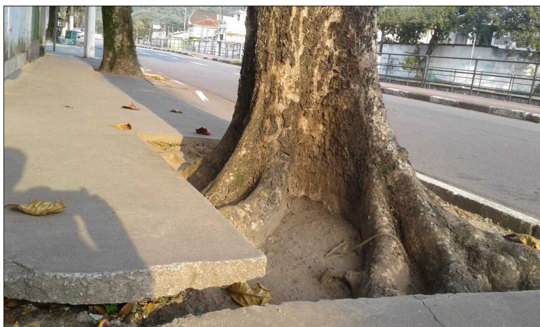
Figura 8.18 Calçada destruída e obstruída por árvore. Fonte: Internet.
