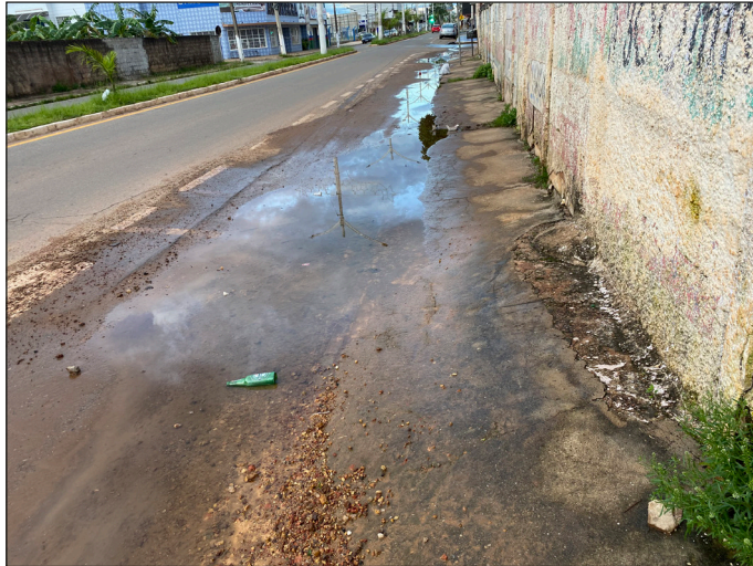
Figura 8.32 Calçada alagada devido à inexistência de guia separando-a da pista. Fonte: Foto dos autores.
