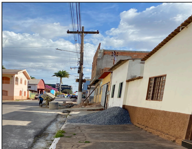
Figura 8.10 Calçada obstruída por material de construção (pedra britada). Fonte: Foto dos autores.
