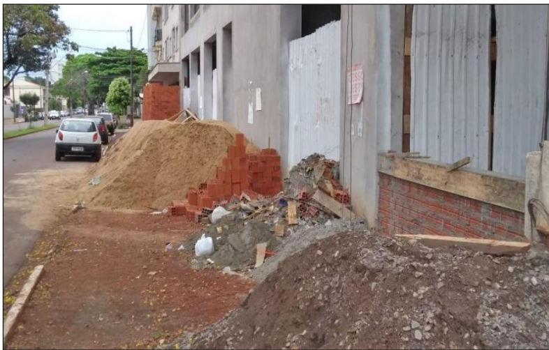
Figura 8.9 Calçada obstruída por resíduos de demolição e material de construção (areia). Fonte: Foto dos autores.
