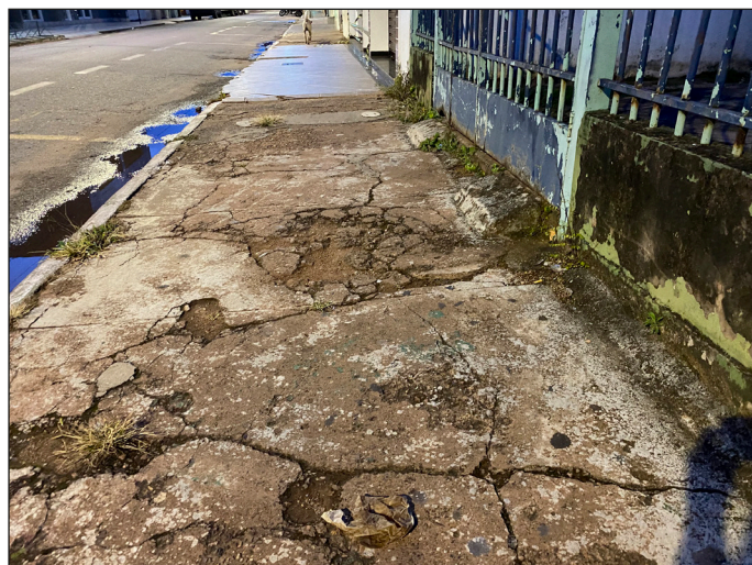
Figura 8.23 Calçada em péssimo estado de conservação. Fonte: Foto dos autores.
