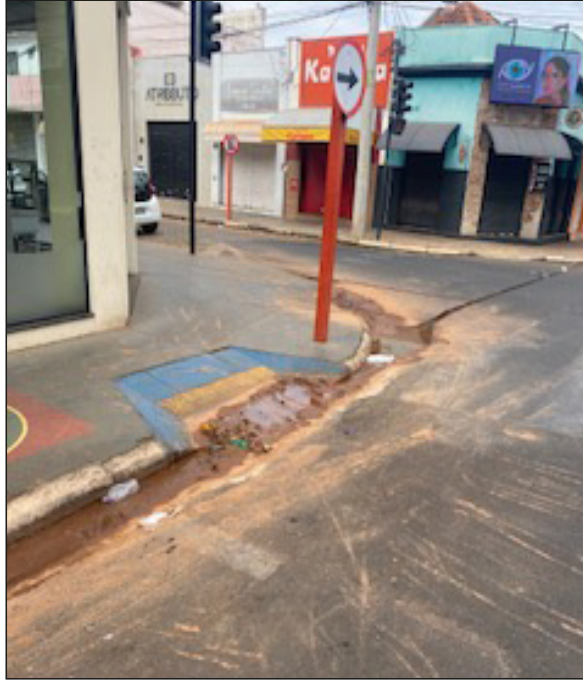
Figura 8.36 Sarjeta com sujeira junto à guia rebaixada por falta de drenagem adequada. Fonte: Foto dos autores.
