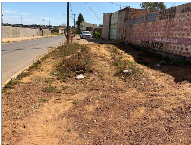
Figura 8.2 Calçada sem revestimento e com superfície irregular. Fonte: Foto dos autores.
