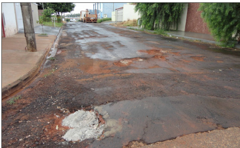
Figura 8.31 Esquina com pavimento em péssimo estado na área travessia de pedestres. Fonte: Foto dos autores.
