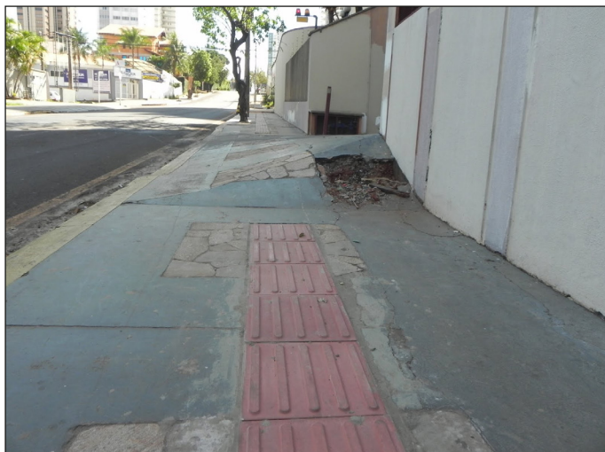
Figura 8.34 Calçada com inclinações longitudinal e transversal excessivas. Fonte: Internet.
