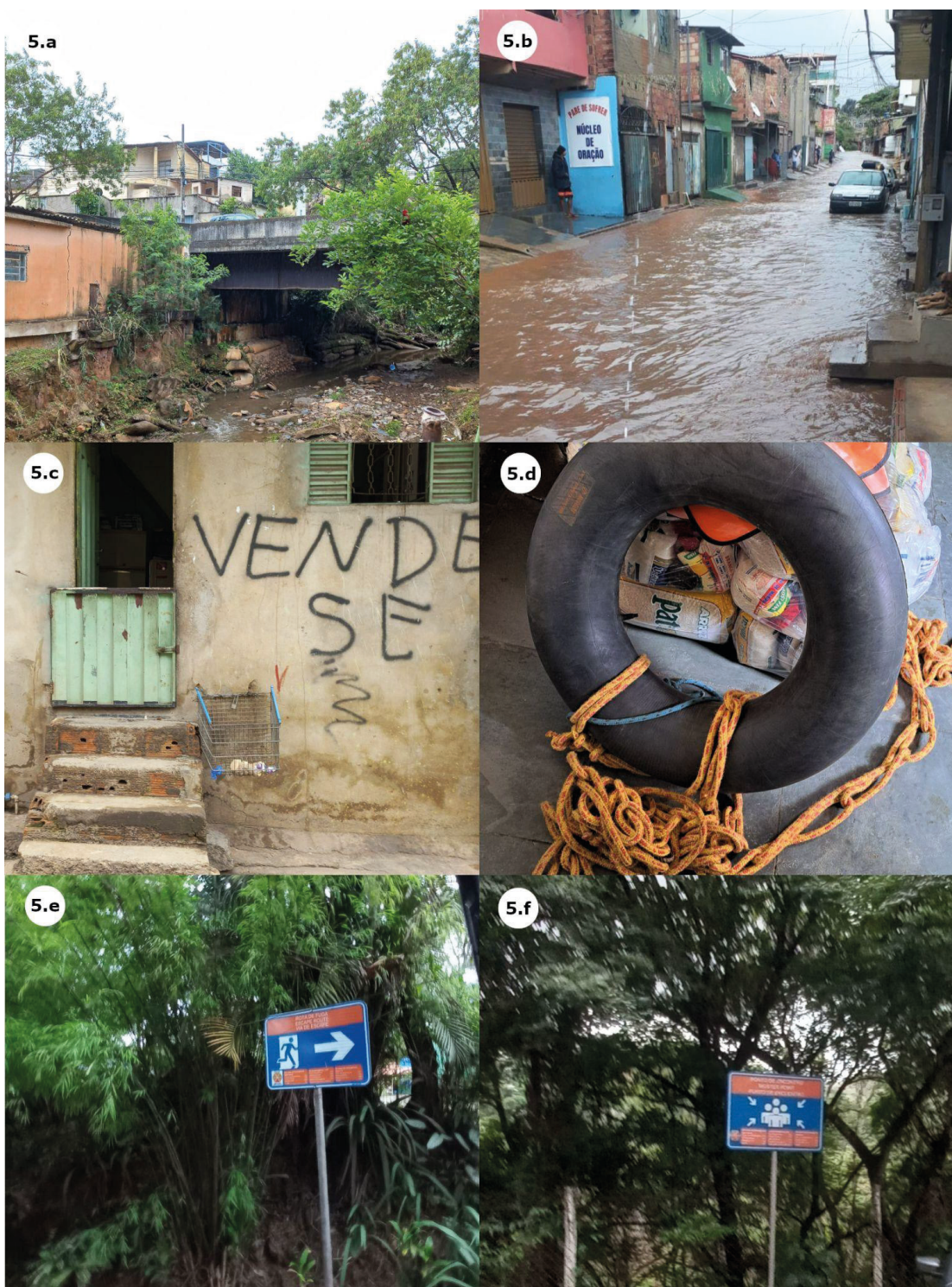
Figura 5 Problemas recorrentes de drenagem urbana, a saber: residências no nível do córrego na Vila Havaí (5.a); na rua principal da Vila Samag (5.b); barreira de entrada de água existente em grande parte das casas da rua, Vila Samag (5.c); boia de salvamento com corda, feita improvisadamente pela liderança local para resgatar pessoas que são levadas pela enxurrada que se forma na rua principal e cestas básicas distribuídas aos moradores mais necessitados da comunidade, Vila Samag (5.d); sinais de rota de fuga (5.e) e ponto de encontro pós-fuga (5.f) em Capela Velha. Imagens: os autores.
